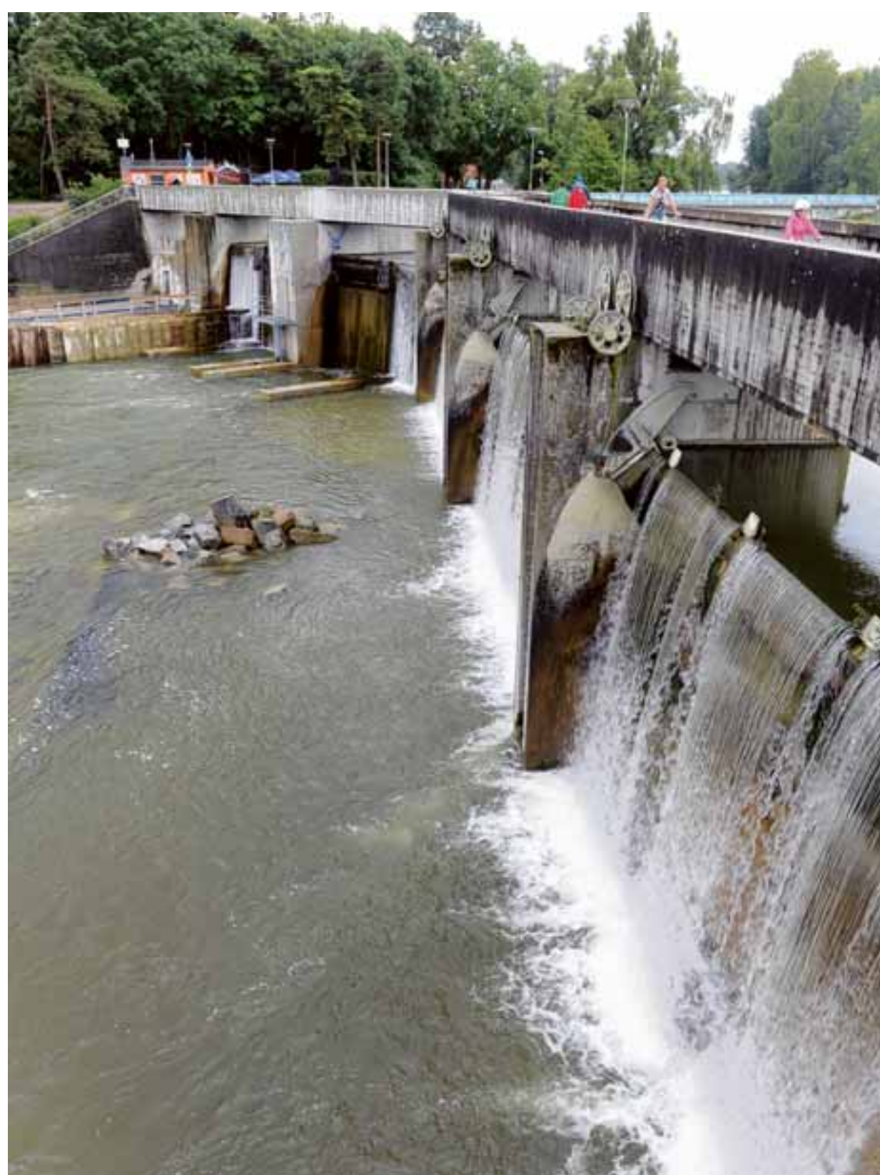
Das Kraftwerk im Hochablass ist kaum zu sehen. Es befindet sich in den beiden Wehrfeldern unter dem neu betonierte Steg (ganz oben). Foto: Silvio Wyszengrad
