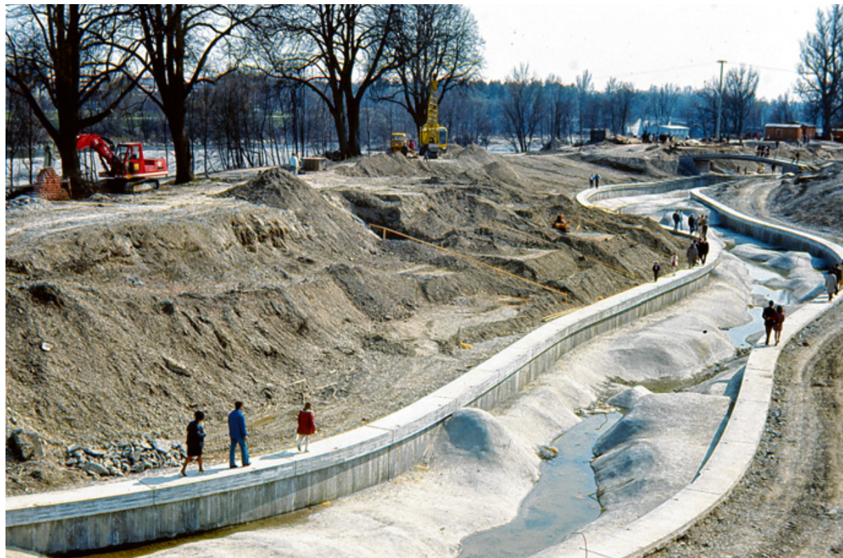
Für den Kanu- und Kajaksport legte die Stadt Augsburg 1972 diese Betonrinne mit künstlichen Stromschnellen an. Jetzt muss über eine entsprechende Sanierung verhandelt werden. Im Juli 1970 gingen vor 8000 Zuschauern sieben Weltmeister letztmals auf der Vorgängerstrecke an den Start.
